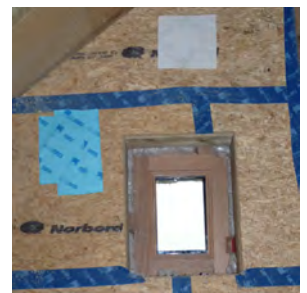
Bandes adhésives étanches sur les joints des panneaux OSB et sur les trous d'insufflation.
