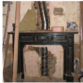
Tuyaux de ventilation dans les cheminées.
