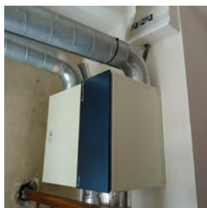
Ventilation double flux avec échangeur de chaleur.
