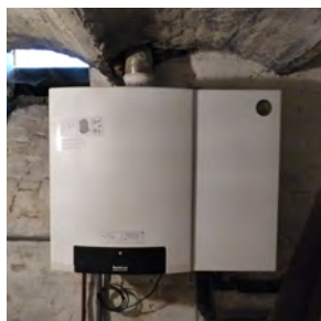
Chaudière gaz à condensation.
