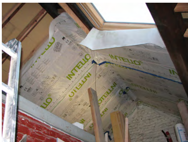
Toiture à versants : pose de la sous-toiture et du freine-vapeur. La cellulose doit encore être insufflée.
