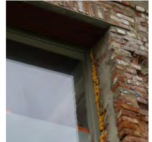
Injections de mousse isolante dans les joints entre les châssis et les murs.
