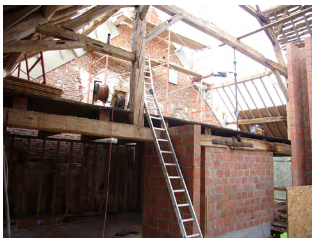
1 er et 2 e étage - mise en place du nouveau plancher et des caissons où la cellulose sera insufflée.
