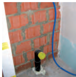
Zone non plafonnée en fond de local sanitaire attendant la pose d'un wc suspendu et d'une contre cloison, Source CSTC
