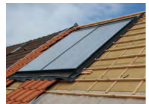
Panneaux solaires thermiques.
