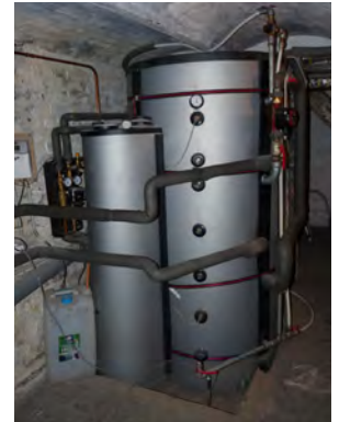
Panneaux solaires thermiques et ballons de préparation et de stockage de l'eau chaude sanitaire.
