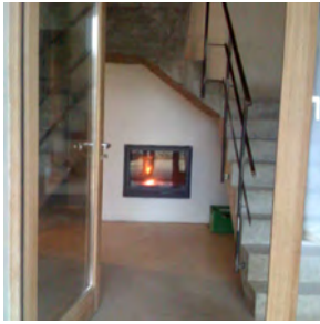
Poêle à bois installé dans la trémie centrale.
