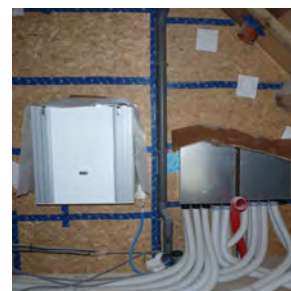
Echangeur et caisson de répartition du système de ventilation hygiénique.
