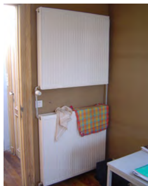
Radiateurs surdimensionnés, à basse température.
