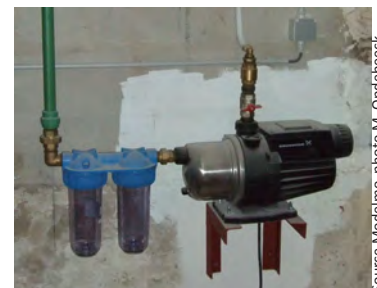
Filtres combinant post filtration et le traitement de l'eau au charbon actif relié au groupe hydrophore
